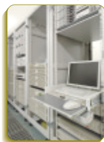
レポートシステム (サーバー)
