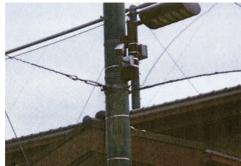
設置された防犯カメラ【写真②】
